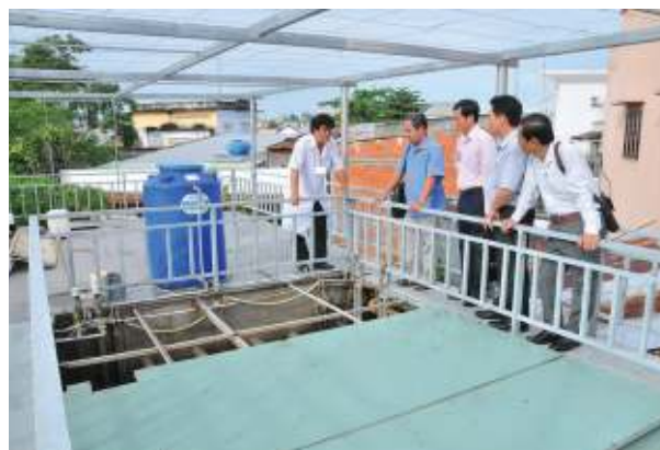
Hệ thống xử lý nước thải bệnh viện Sa Đéc
